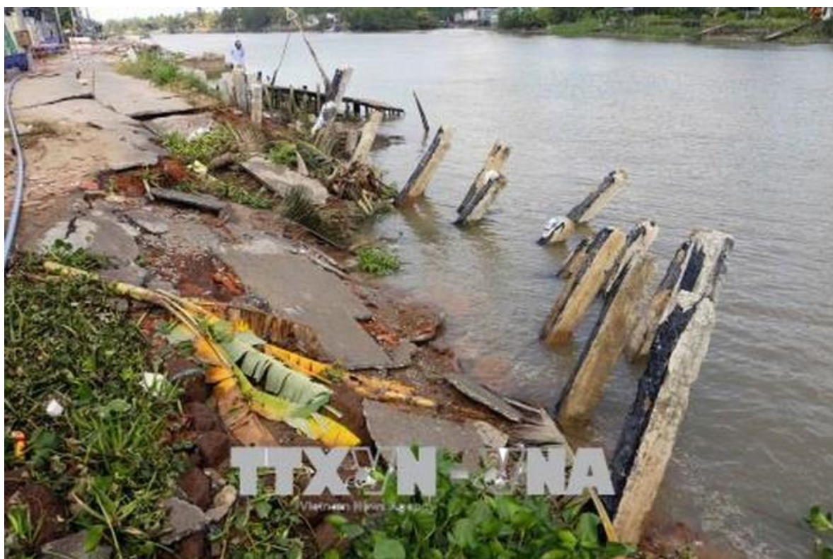
Các cọc bê tông kê sông Ô Môn (Cần Thơ) bị sạt lở đẩy dạt ra phía ngoài. Ảnh: Thanh Liêm/TTXVN
