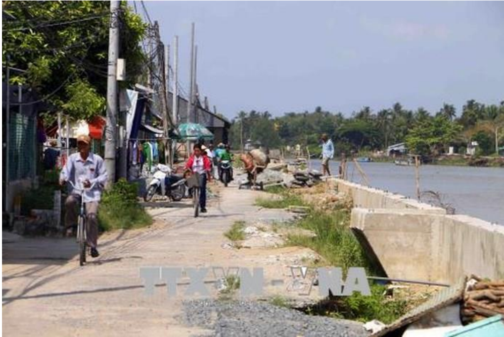
Khu vực xây ra sạt lở mới nhất vào ngày 6/4/2018 là nơi đang thi công dự án kè chống sạt lở sông Ô Môn (Cần Thơ) giai đoạn 3. Ảnh: Thanh Liêm/TTXVN
